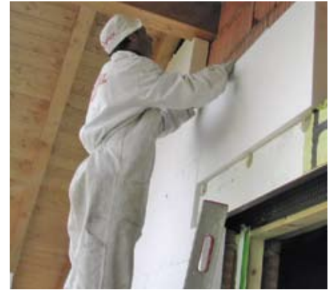
Durch eine nachträgliche Außendämmung wird der Grenzabstand nicht verletzt.
